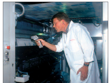
La mesure infrarouge régulière de la température permet d'identifier toute température anormale révélatrice de problèmes. Photo Sun Chemical.
