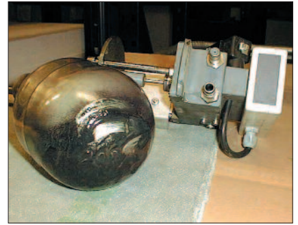
Les salissures accumulées sur le flotteur de stabilisation d'alcool augmentent son poids et peuvent modifier la teneur en alcool de la solution de mouillage. Photo Technotrans.
