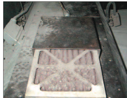
La poussière environnante de la presse est aspirée par l'armoire électrique et capturée par le filtre. Si le filtre n'est pas nettoyé, les composants électriques risquent de surchauffer et de s'endommager, pouvant même occasionner un incendie.
